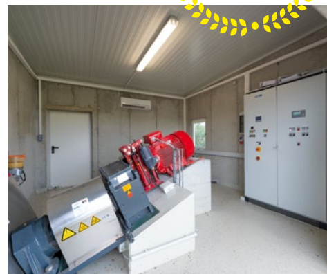
Maschinenhaus der Restwasserschnecke
