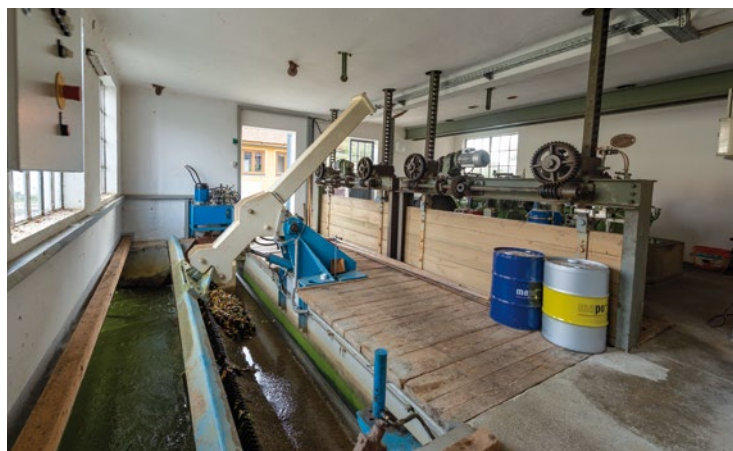
Rechenreinigungsanlage mit Einlaufschütz, dahinter Maschinensatz
